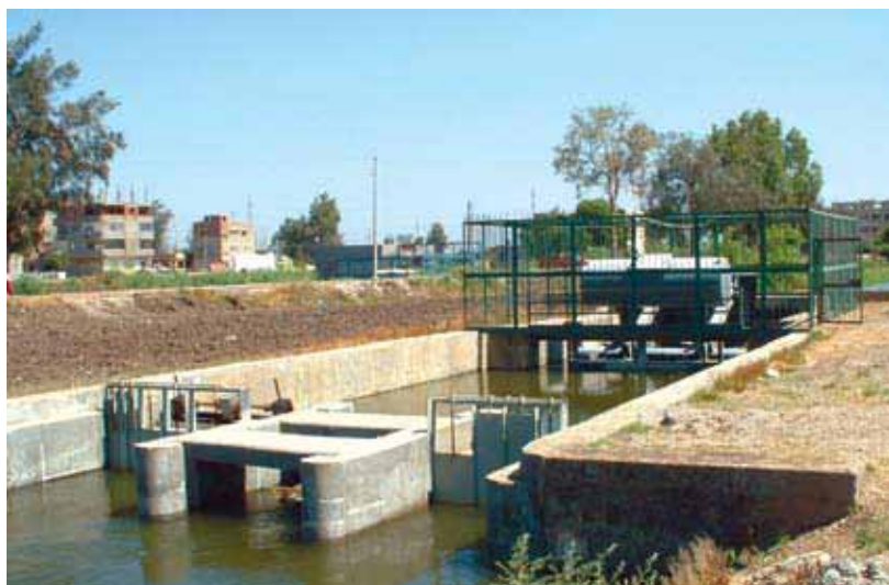
Vanne à commande par l'aval (photo : J. Hoevenaars)
