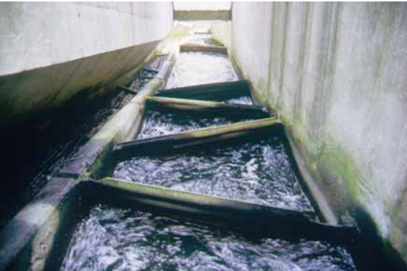
Şekil 5.40: Rosport'taki (Rhineland-Palatinate) Sauer barajına inşa edilmiş paralelkenarlı geçit ve yılan balığı merdiveni.
