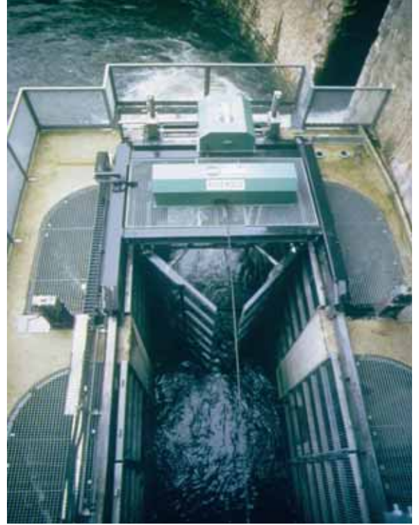
Şekil 5.47: Tuilières balık asansörünün alt girişi
