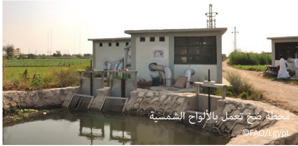
محطة ضخ تعمل بالألواح الشمسية ©FAO/Egypt
