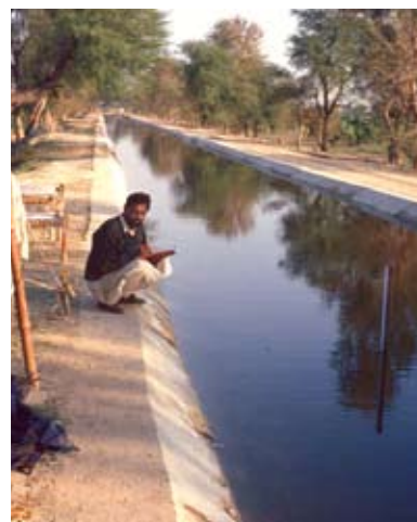
Medición de pérdidas por filtración en Fordwah-Sadiqia, Punjab, Pakistan.
