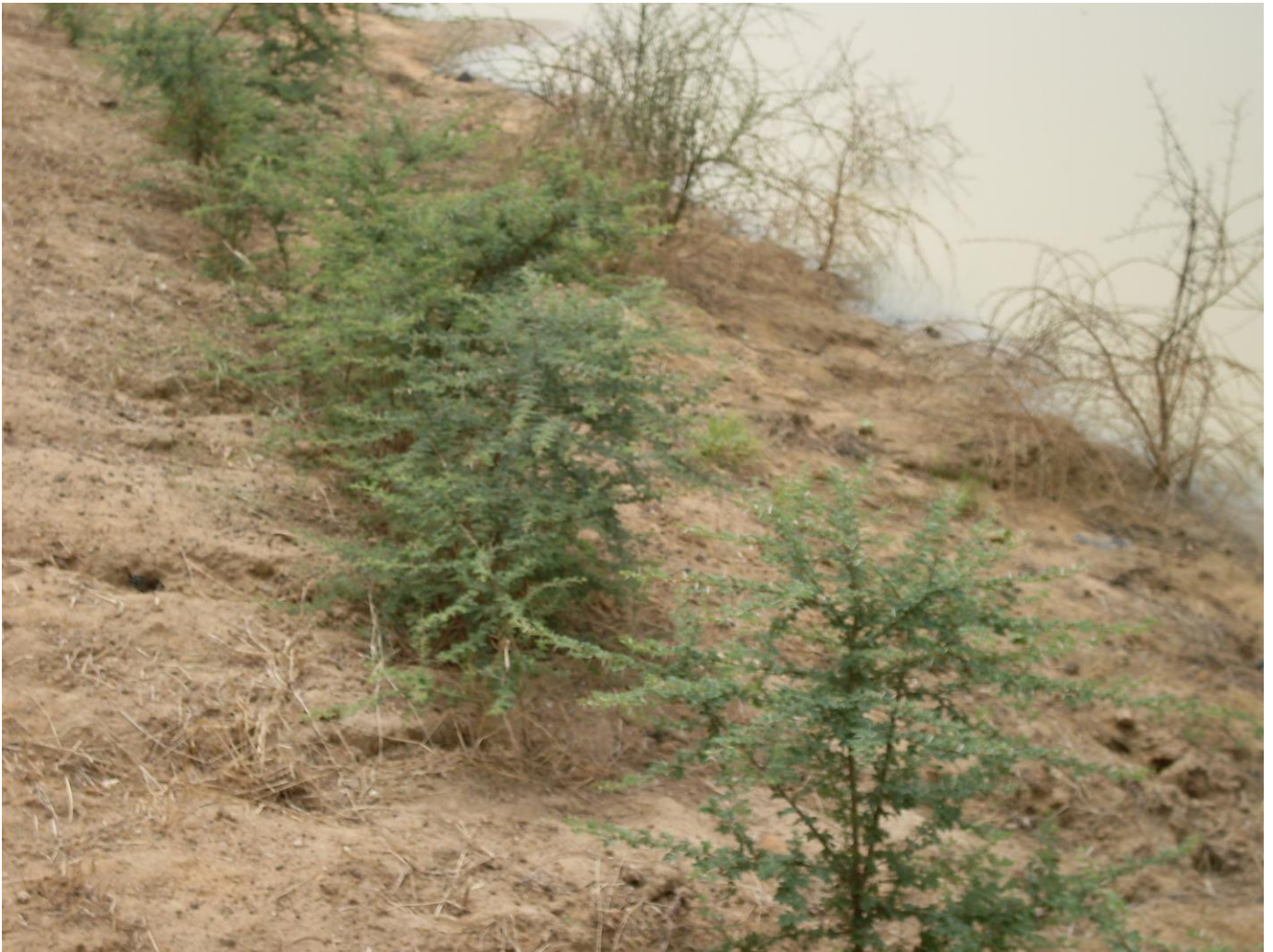
Bassin de rétention réalisé à Labgar en 2009, avec reboisement des berges pour la protection
